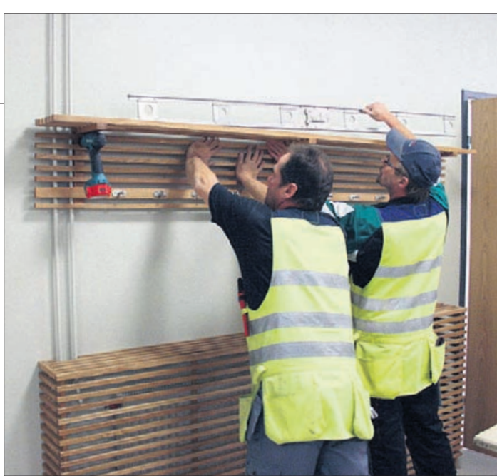
Jari Korkeamäki och Hannu Autio tar ett stort vattenpass till hjälp för att få hatthyllan i Solängens entré att hänga helt vågrätt.
