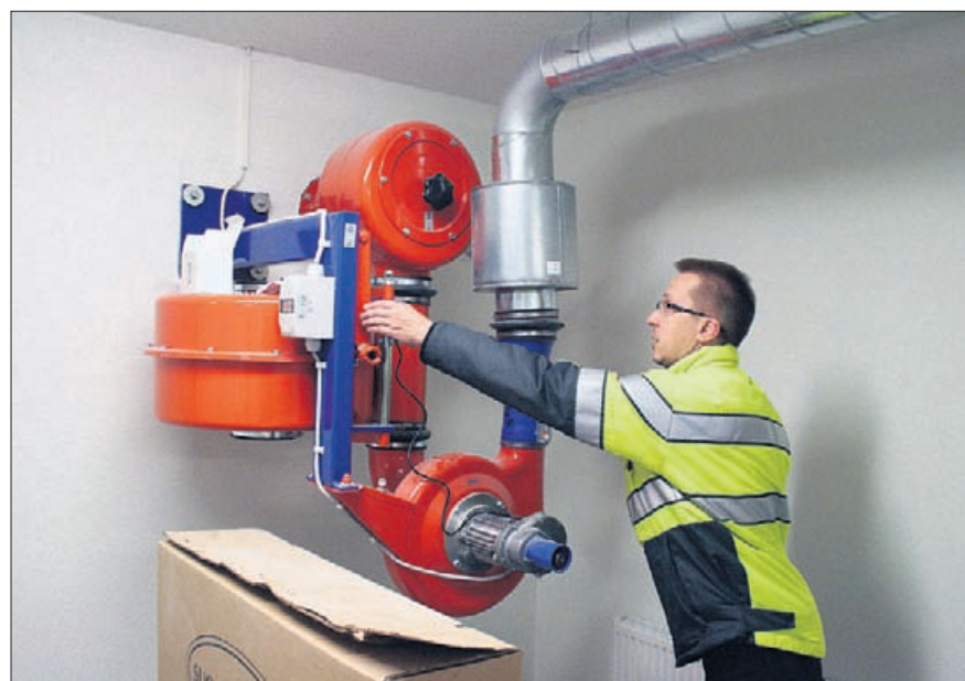
Huvudprojektledare Christer Lindqvist visar spaken som vid behov kan användas för att manuellt sköta ventilationsanläggningen i befolkningsskyddet i Solängens källare.
